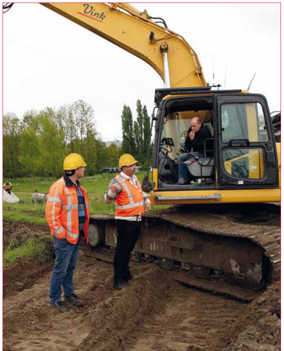
André van Leeuwen en uitvoerder Frank ter Maten bij het project onder de rook van luchthaven Zestienhoven in Rotterdam.
